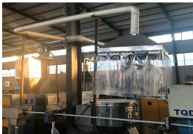
图 19 记米印字工序集气罩（三车间）
