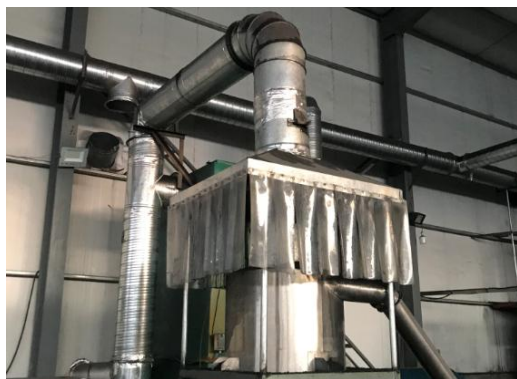
图 10 原料车间混料工序集气罩
